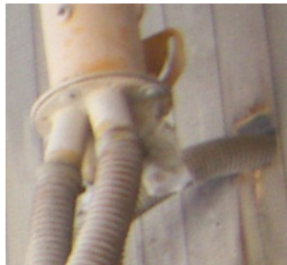
Bild 14: Falsch dimensionierte Rohrdurchmesser
