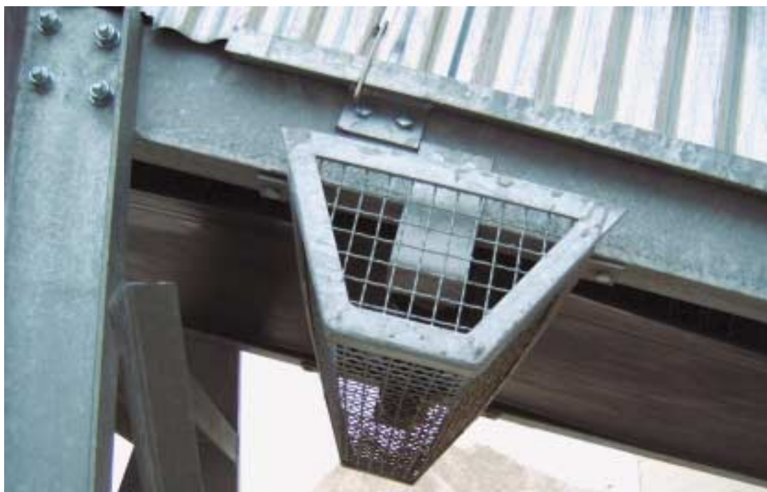
Abb. 13: Untergurttragrolle; Sicherung durch Schutzkorb
