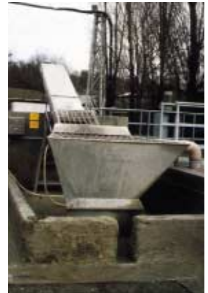
Abb. 42: Recycling-Anlage mit Austragsschnecke
