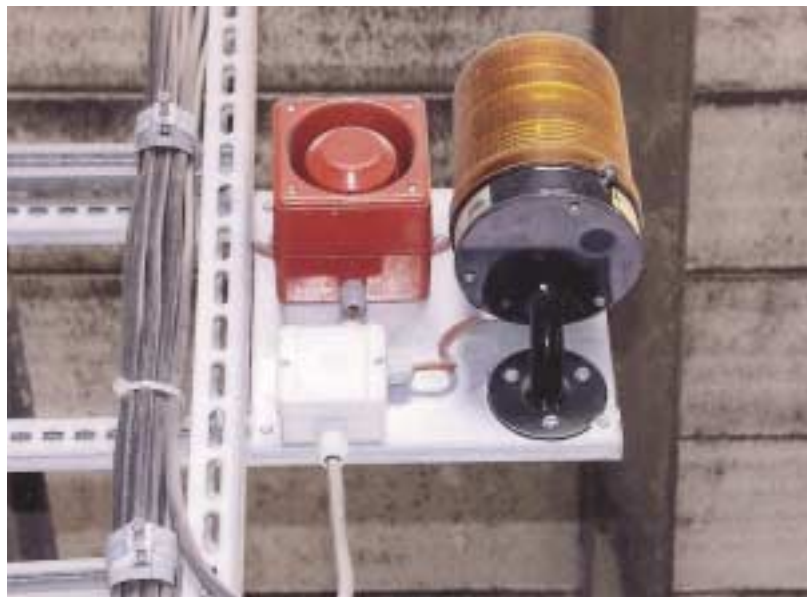
Abb. 20: Akustische und optische Anlaufwarneinrichtung
