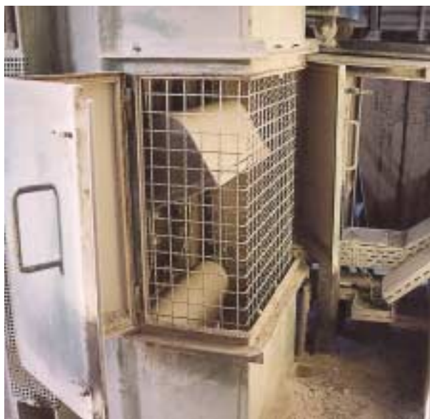
Abb. 39: Schutzgitter an einer Schauöffnung
