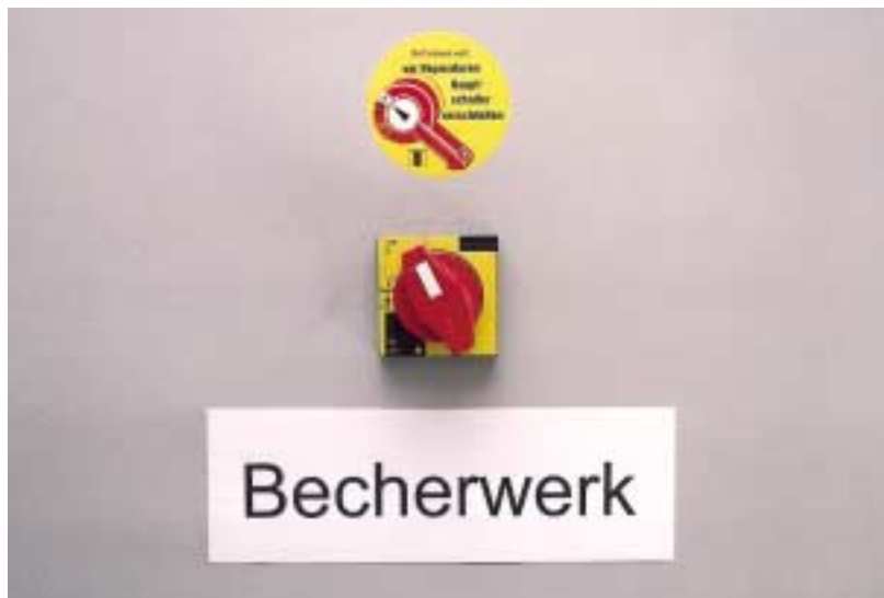
Abb. 46: Eindeutig gekennzeichnet: der Hauptschalter
